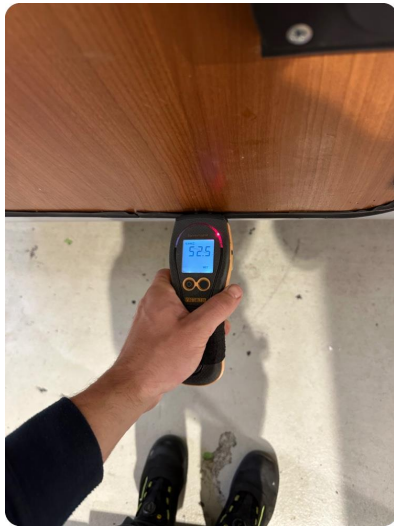
1 Målt fukt i % 75 Fukt i lasteromsluke.
