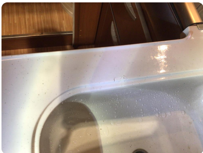
5.1 Slitt kjøkkenbenk Skadet kjøkkenbenk.
