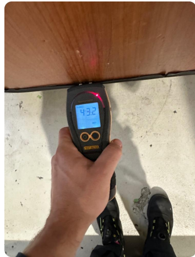
1 Målt fukt i % 75 Fukt i lasteromsluke.
