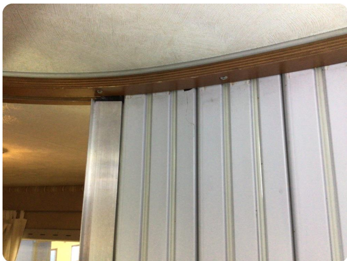
5.2 Skade på innredning Dusjdør knekt og går veldig dårlig. Må skiftes.
