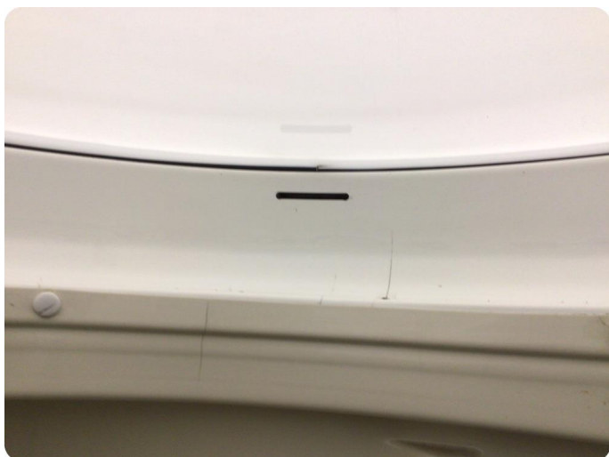
5.3 Sprukket Store rund takluke i dusj ødelagt.
