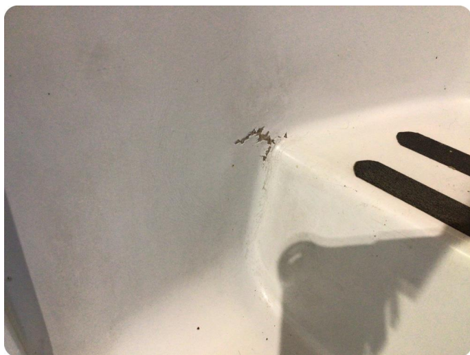
4.1 Sprekk Inngang må repareres.
