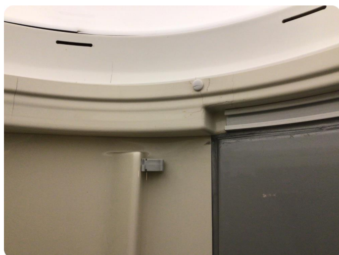
5.3 Sprukket Store rund takluke i dusj ødelagt.
