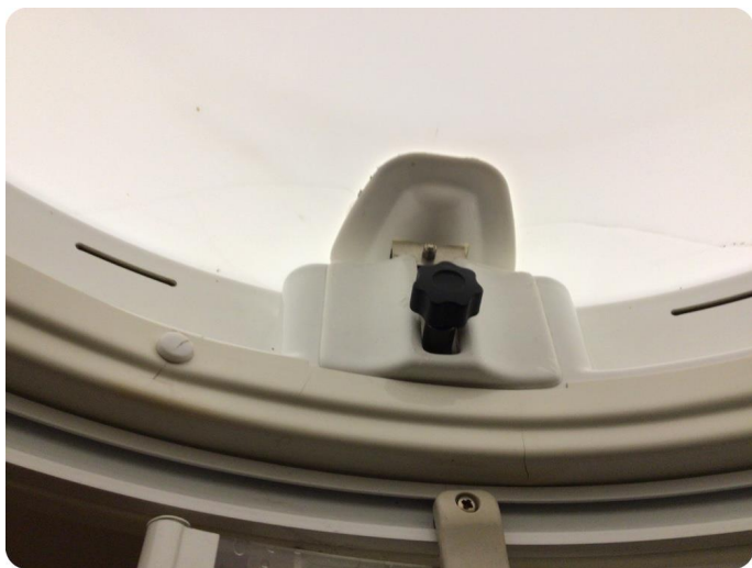
5.3 Sprukket Store rund takluke i dusj ødelagt.
