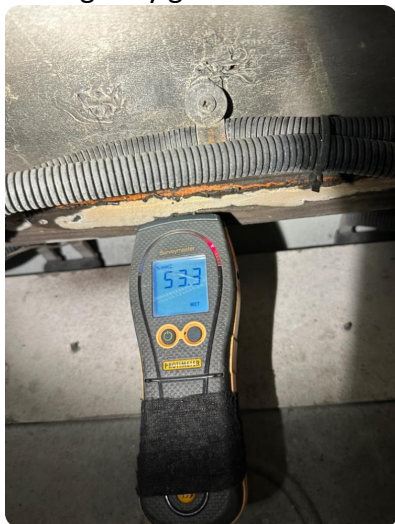
2 Målt fukt i % 80 Kjøretøyet trenger ny gulv i lasterom.
