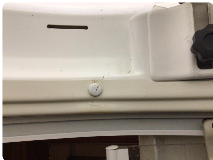
5.3 Sprukket Store rund takluke i dusj ødelagt.
