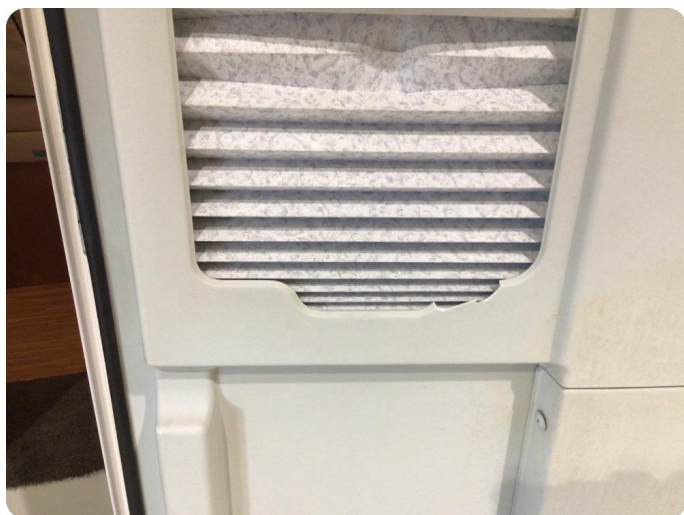
3.1 Skadet/merker etter utstyr Dørtrekk knekt.
