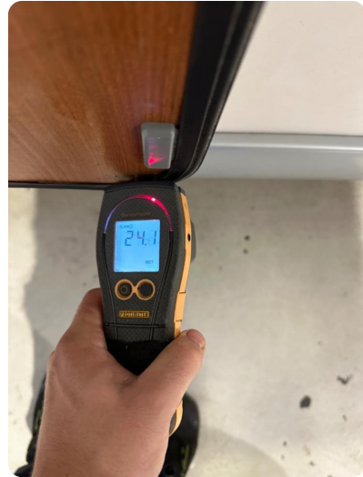
1 Målt fukt i % 75 Fukt i lasteromsluke.
