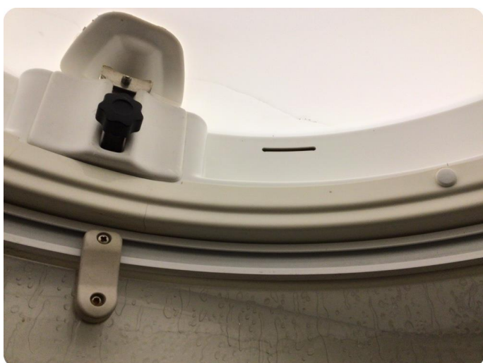
5.3 Sprukket Store rund takluke i dusj ødelagt.
